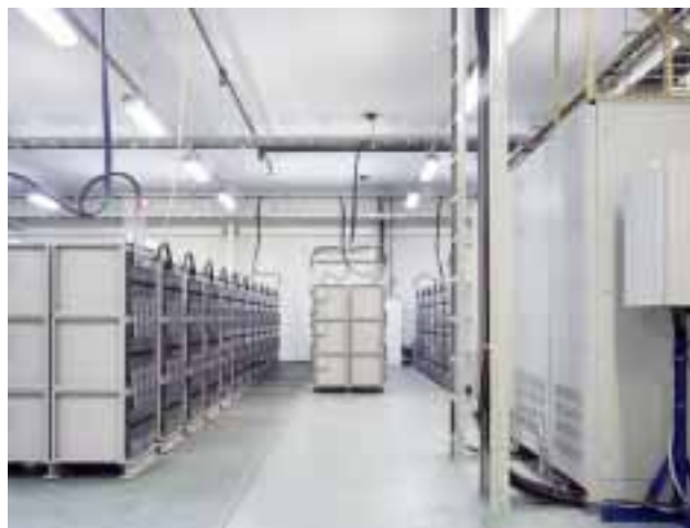
蓄電池設置例
